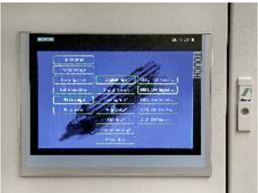
Painel Touch Screen para Operação do Sistema de Bombeamento
