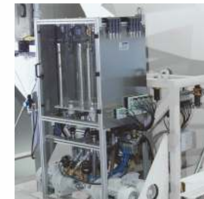
Sistema de pesaje de aditivo.
