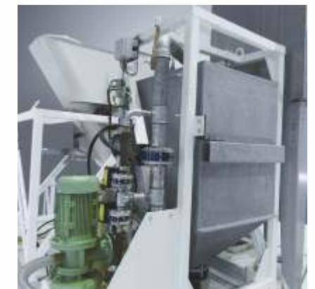
Sistema de pesaje de agua con Bomba de descarga para alimentación presurizada de agua para la Mezcladora.
