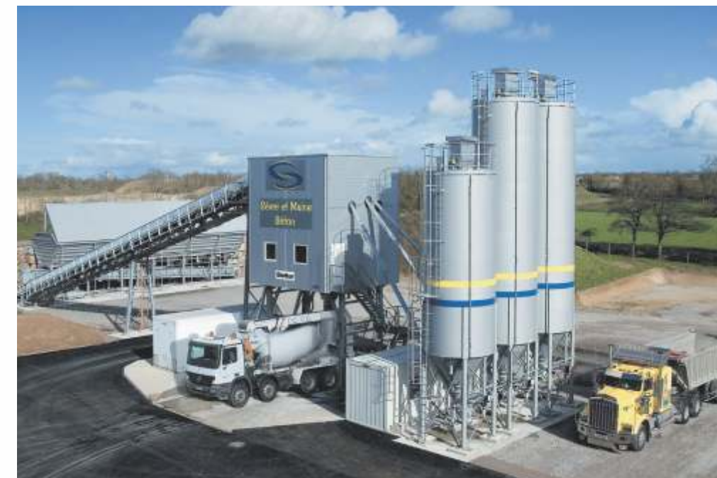
Central HN com misturador planetário. Capacidade de 78 m 3 /h de concreto compactado.
