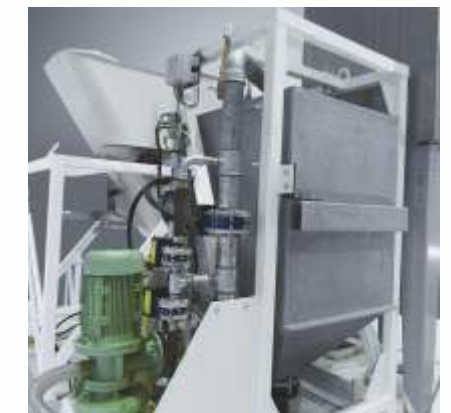
Sistema de pesagem de água com bomba de descarga para alimentação pressurizada de água para o misturador.
