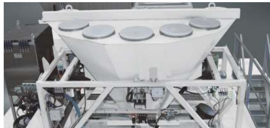
Sistema de pesagem de cimento.
